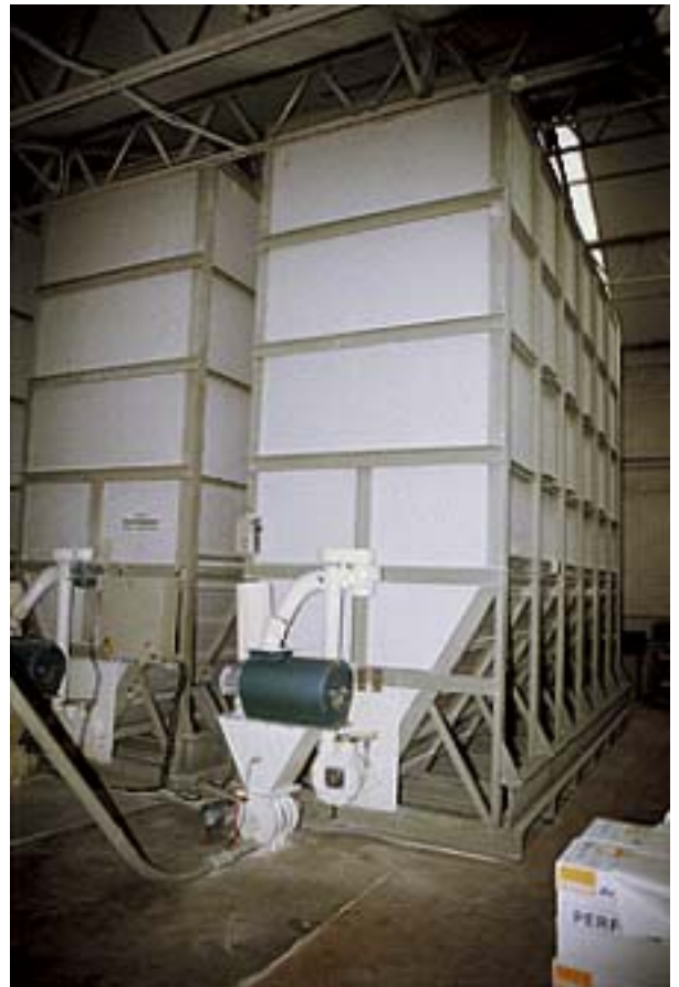
Transport de la farine en circuit étanche.
