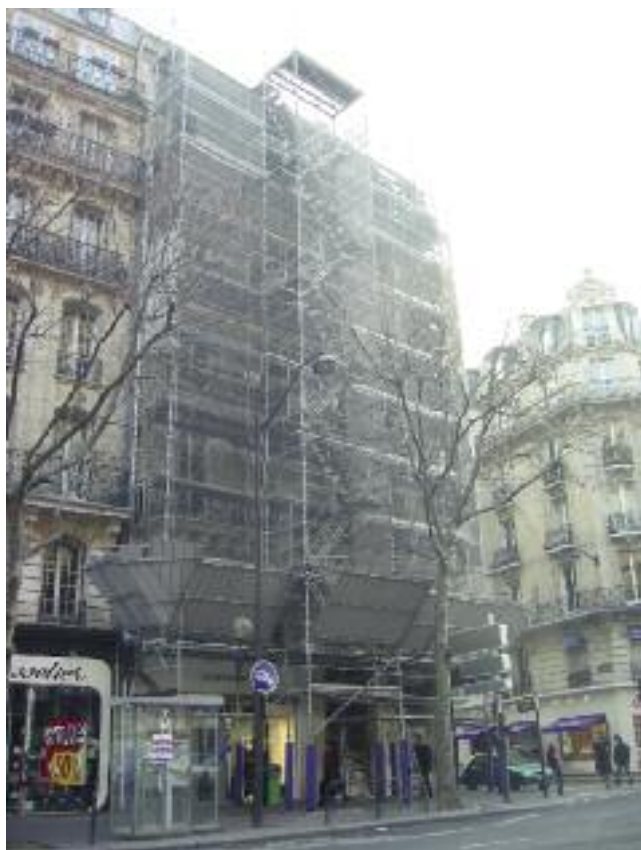
◀ Fig. 9 – Échafaudage avec sapine d'accès servant pour le ravalement et les travaux de couverture
