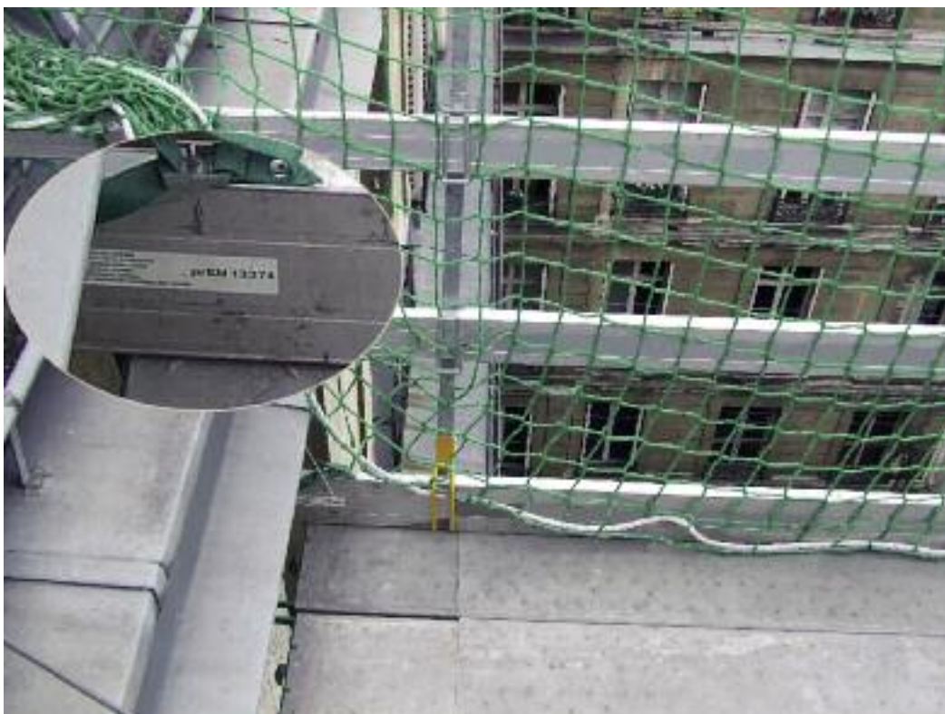
Fig. 6 – Garde-corps avec filets conforme à la norme NF EN 13374
