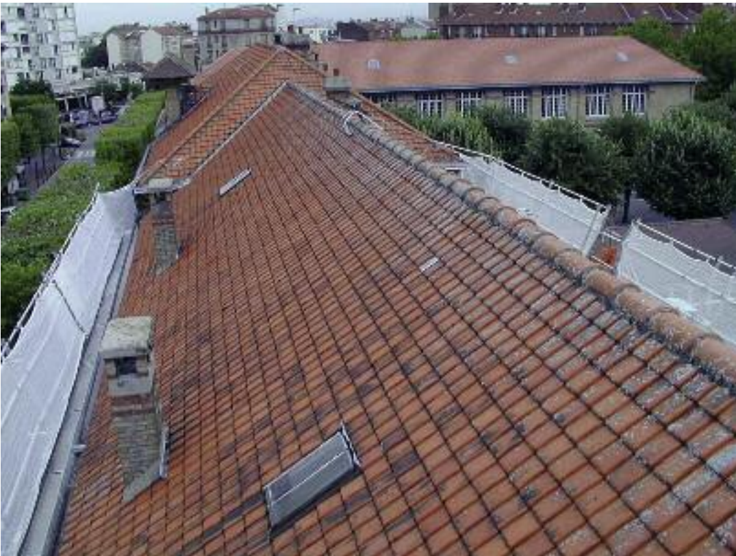
Fig 28 – Protections bas de pente vues du toit
