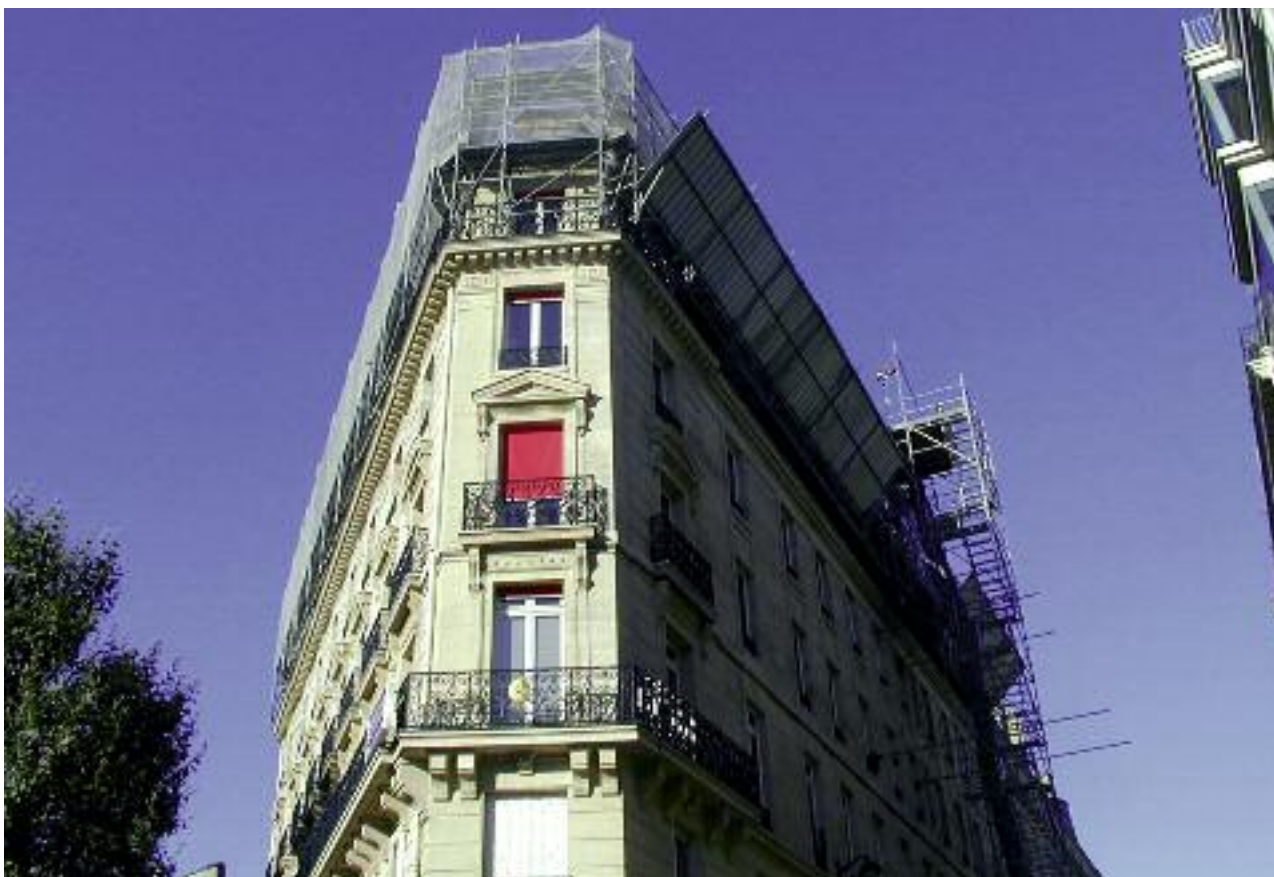
Fig. 12 – Plancher de travail – protection bas de pente – sur échafaudage multidirectionnel prenant appui sur balcons, avec pare-gravats, monte-matériaux et tour d'accès
