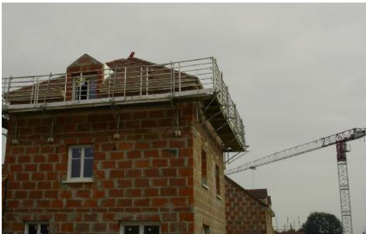
Fig. 21 – Échafaudage sur consoles assemblé et mis en place à partir du sol
