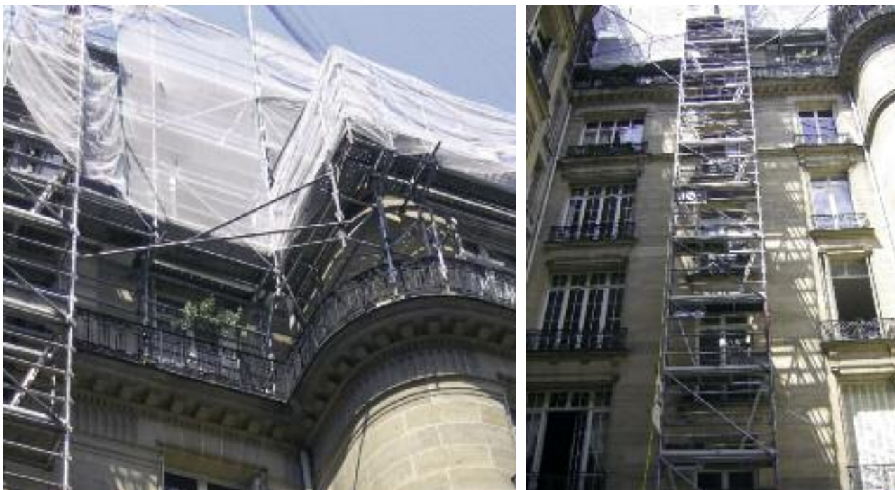
Fig 13, 14 – Plancher de travail sur échafaudage en appui sur balcon et tour d'accès dans courette
