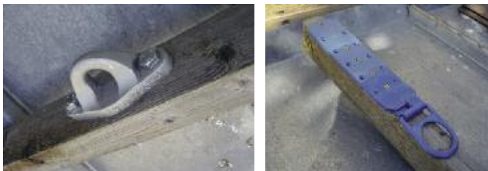
Fig. 29 et 30 – Points d'ancrage conformes à la norme EN 795-A
