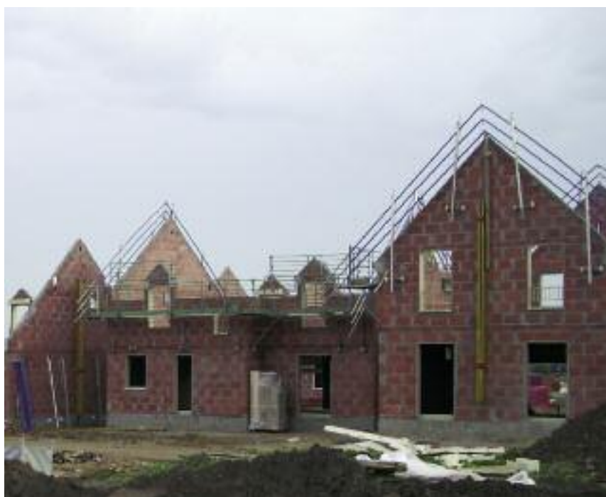
Fig. 6 – Garde-corps en rive de toiture
