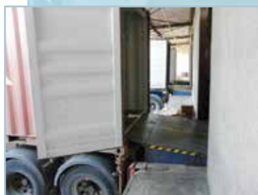
Forte dénivellation du niveleur
