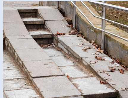
Chutes de plain-pied : pentes ; sols humides, glissants, dégradés ; obstacles.
